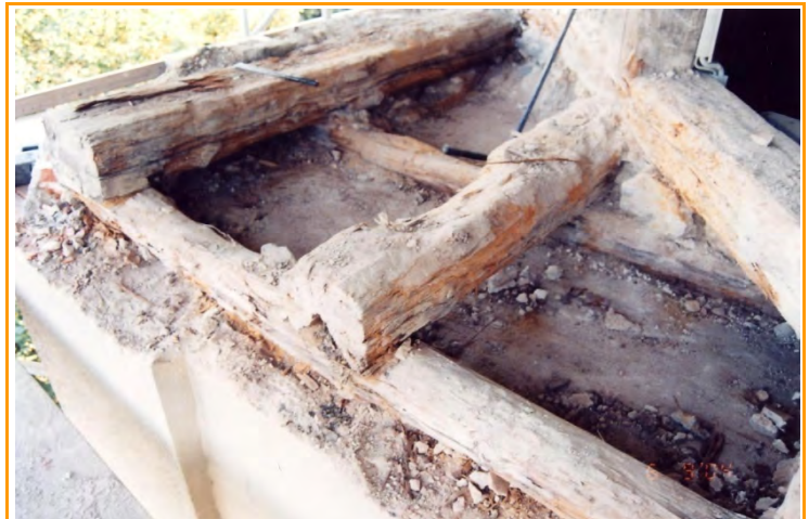
Schäden an Mauerbalken, Deckenbalken, Schwellen
