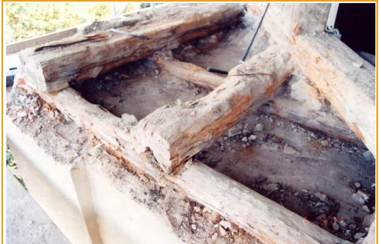
Schäden an Mauerbalken, Deckenbalken, Schwellen
