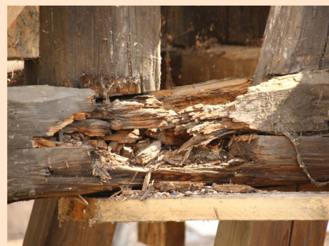
geschädigte bzw. fehlende Holzkonstruktion im Turm
