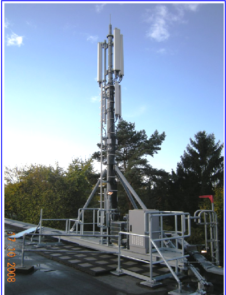
Gesamtansicht Antennenträger mit Unterkonstruktion
